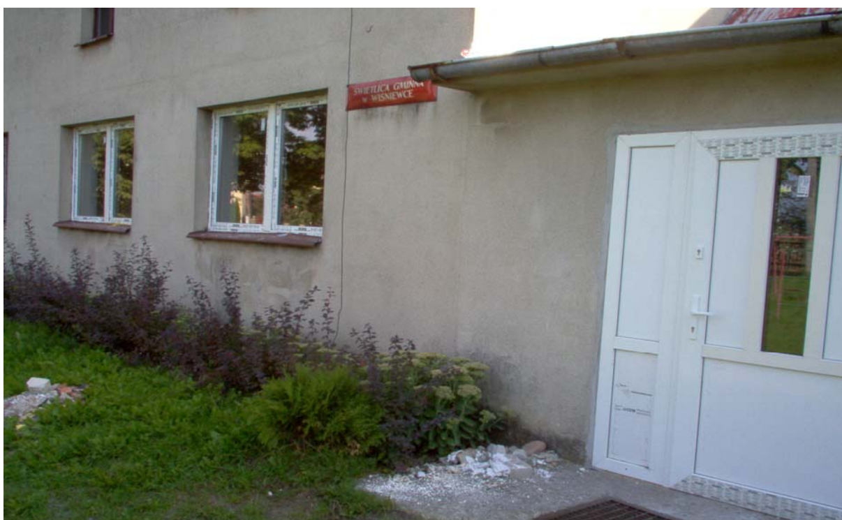
Wymieniona stolarka okienna i drzwiowa w ramach „Planu Odnowy Miejscowości” w 2006 r.
