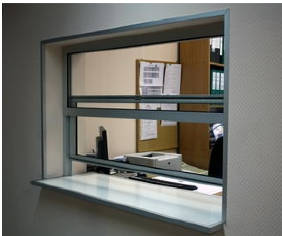
Okno kasowe z mikrofonem i głośnikiem, dodatkowe oświetlenie w otworze okna.
